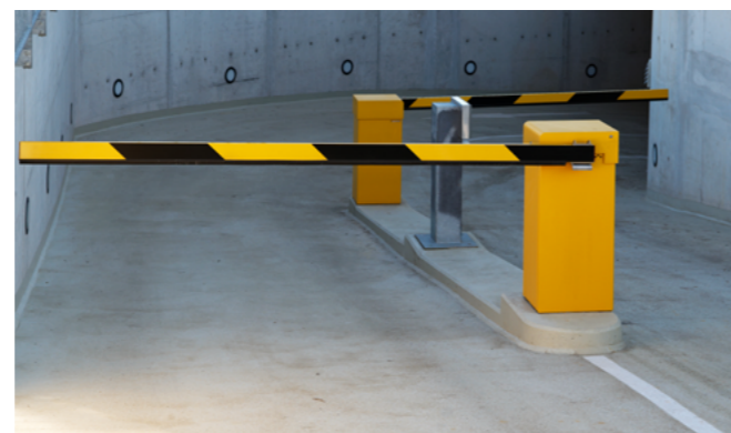
Automatización de accesos
